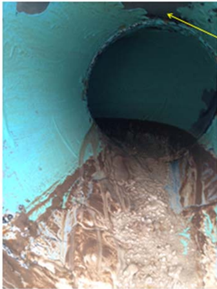
ZDS U-bend piping
